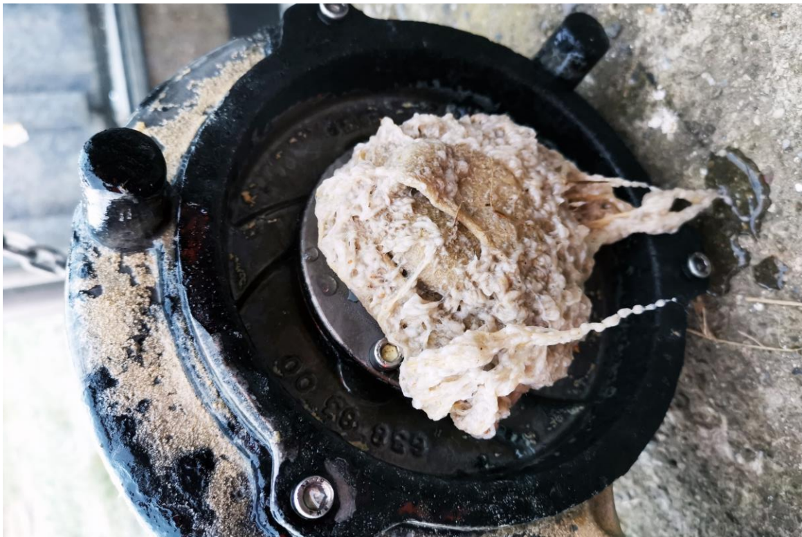
Bildlegende: Teil einer verstopften Abwasserpumpe. Bild: Abwasserverband Region Romanshorn
